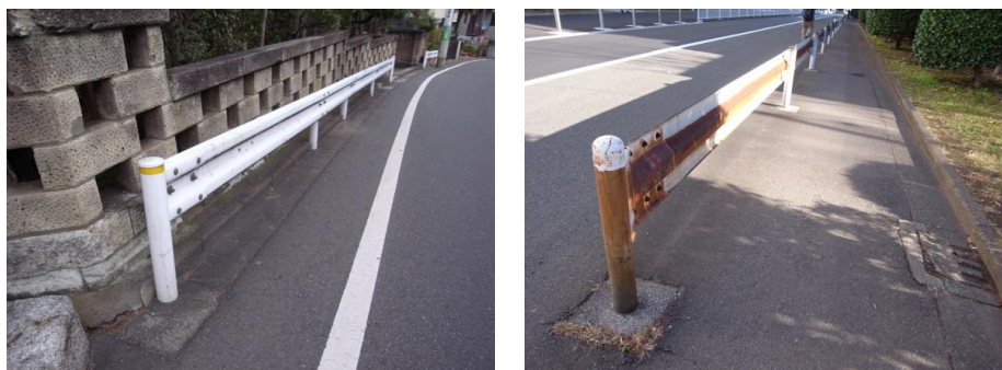
塀を守るためのガードレールでここでは該当しない例(左)と歩行者を守るガードレールで該当する例(右)
