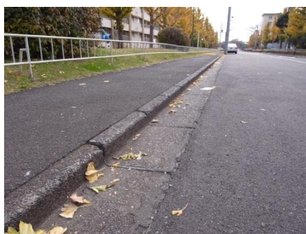
道路に段差がある例
